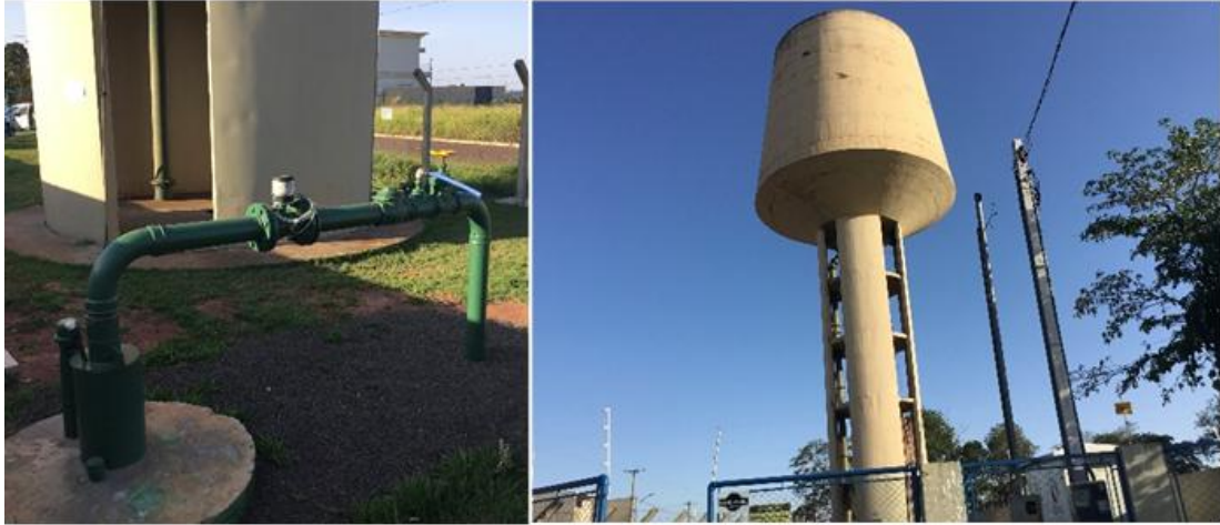
Figura 18: Poço AMA 14 e reservatório elevado.
