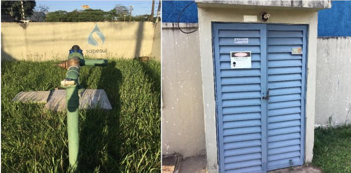
Figura 20: Poço AMA 005 e sistema de telecomando.
