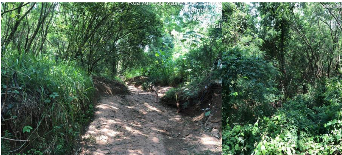
Figura 49: Ponto 10 de verificação da drenagem – DRE 10 (processo erosivo).
