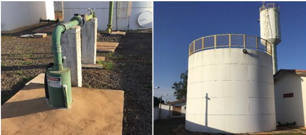
Figura 21: Poço AMA 013 e os reservatórios apoiado e elevado.
