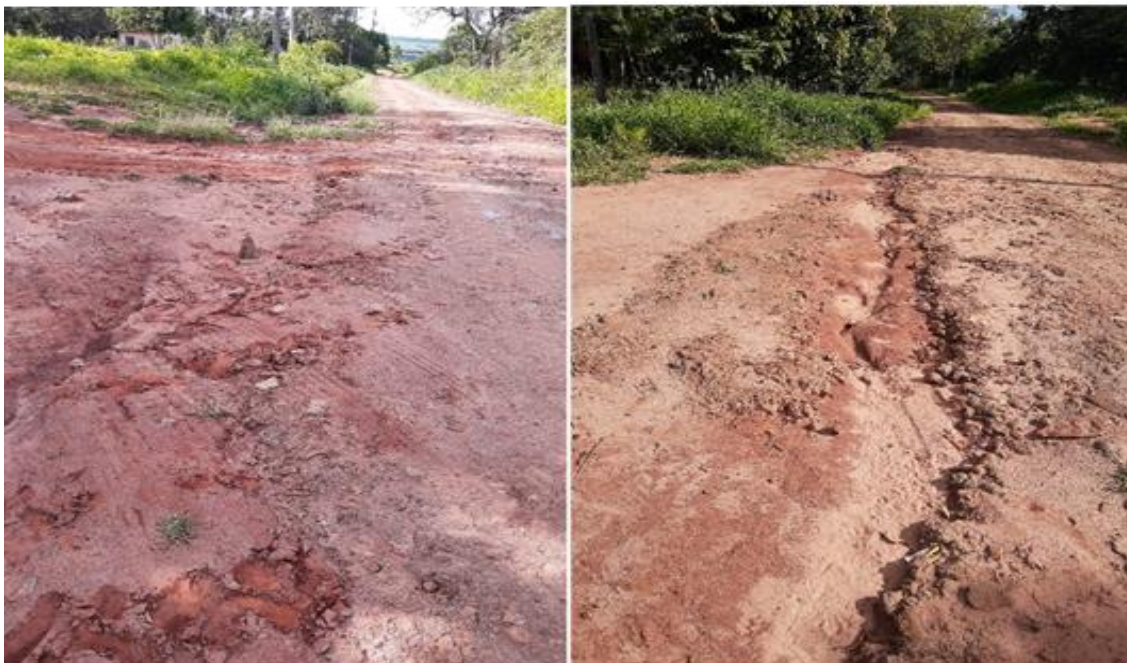
Figura 144: Ponto 02, com presença de sulcos formados no solo, devido ao escoamento de água no local.
