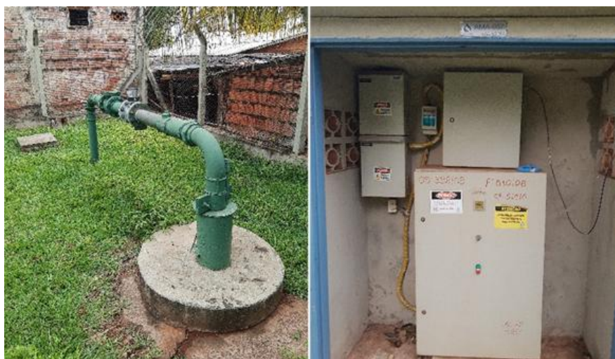
Figura 16: Poço AMA 007 e sistema de telecomando.
