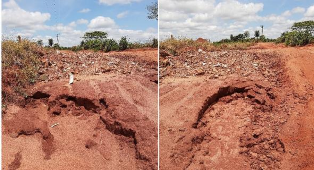
Figura 125: Entulhos dispostos sobre erosão no Ponto 03.
