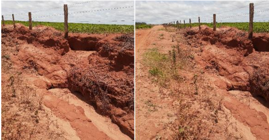
Figura 124: O processo erosivo já adentra a propriedade rural.
