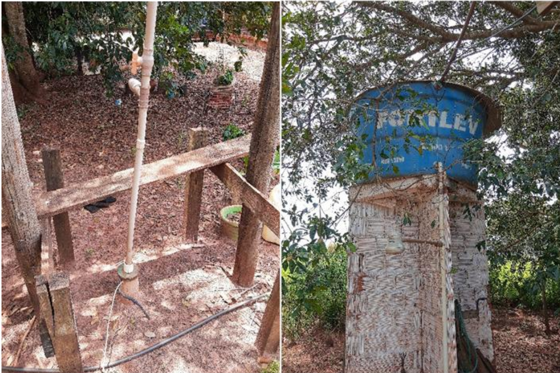
Figura 118: Poço artesiano particular com reservatório de 2.000 litros, no Assentamento Rural Sebastião Rosa da Paz.
