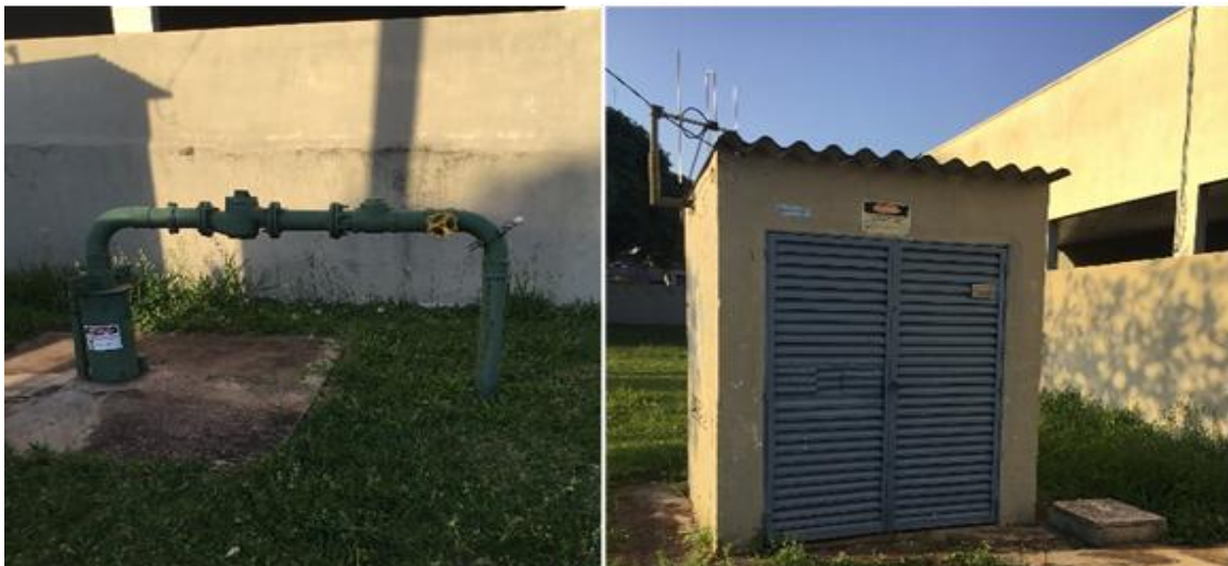
Figura 19: Poço AMA 002 e sistema de telecomando.
