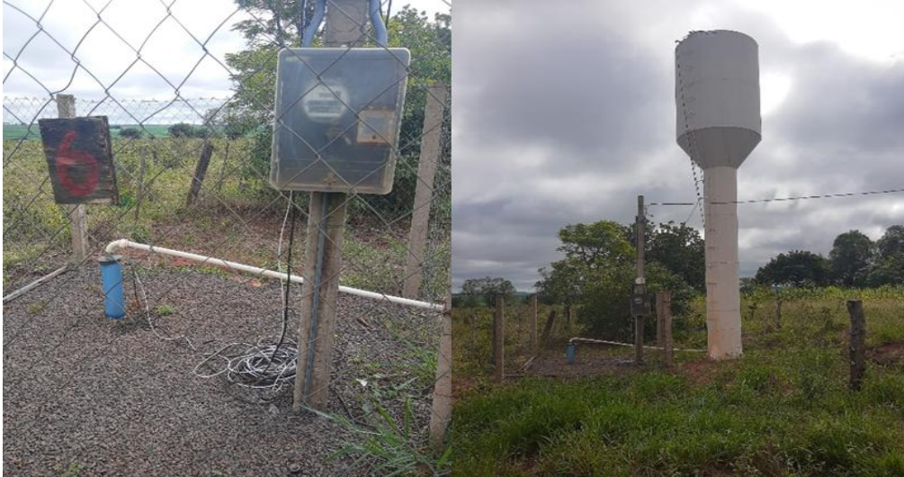
Figura 132: Poço e reservatório da associação de moradores 06, no assentamento Querência.
