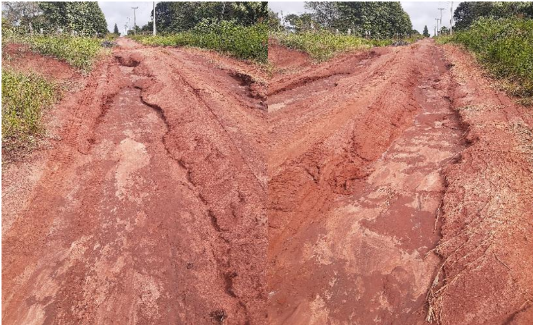
Figura 135: Ponto em estrada do assentamento Querência, com erosão superficial ocorrendo.
