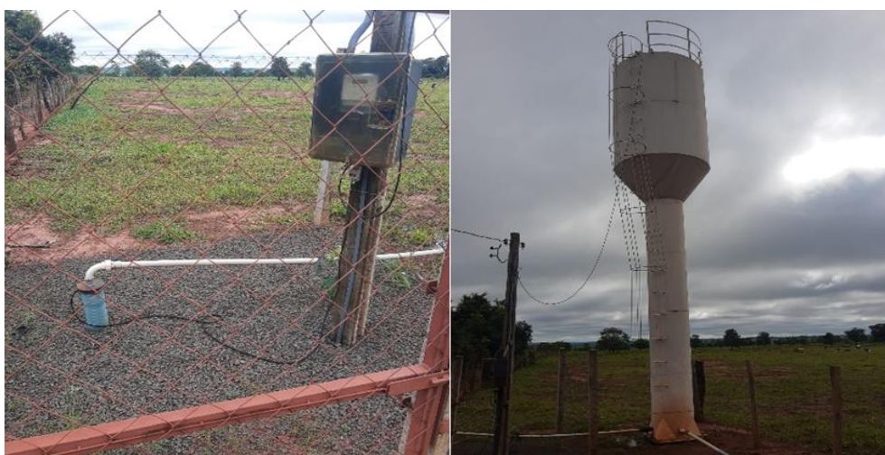
Figura 131: Poço e reservatório da associação de moradores 05, no assentamento Querência.
