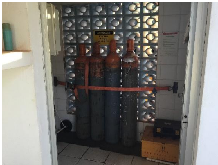
Figura 12: Cilindros de cloros líquido gasoso.
