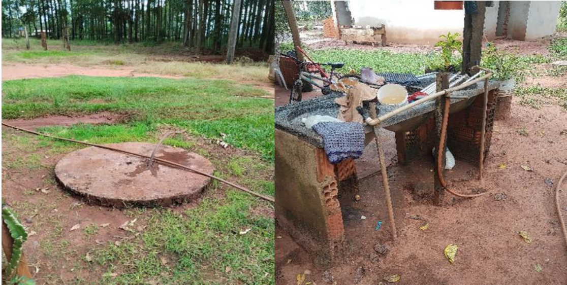
Figura 139: Fossa séptica e despejo de efluente da lavanderia sobre o solo, no assentamento Magno de Oliveira.
