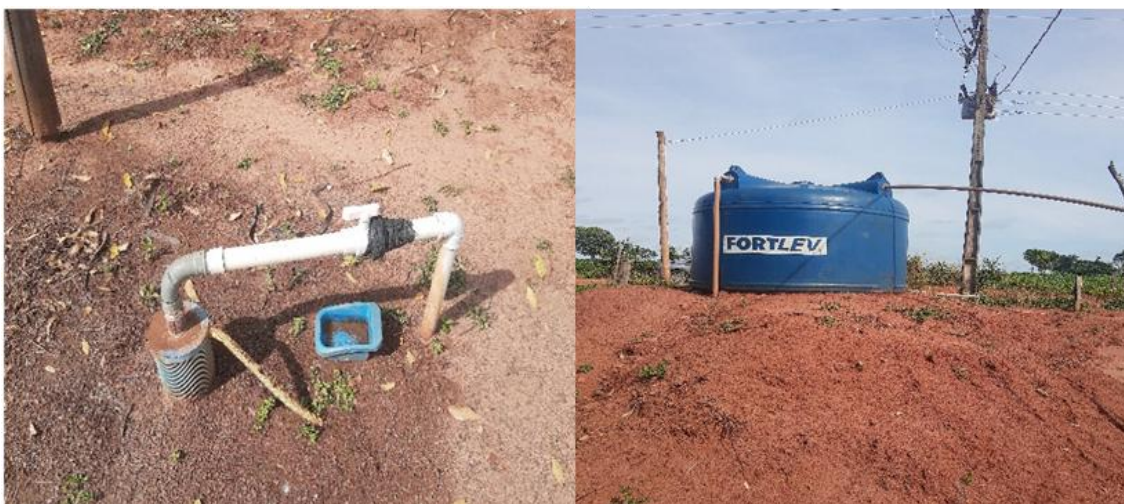
Figura 110: Poço e reservatório 02 no Assentamento Rural Guanabara.
