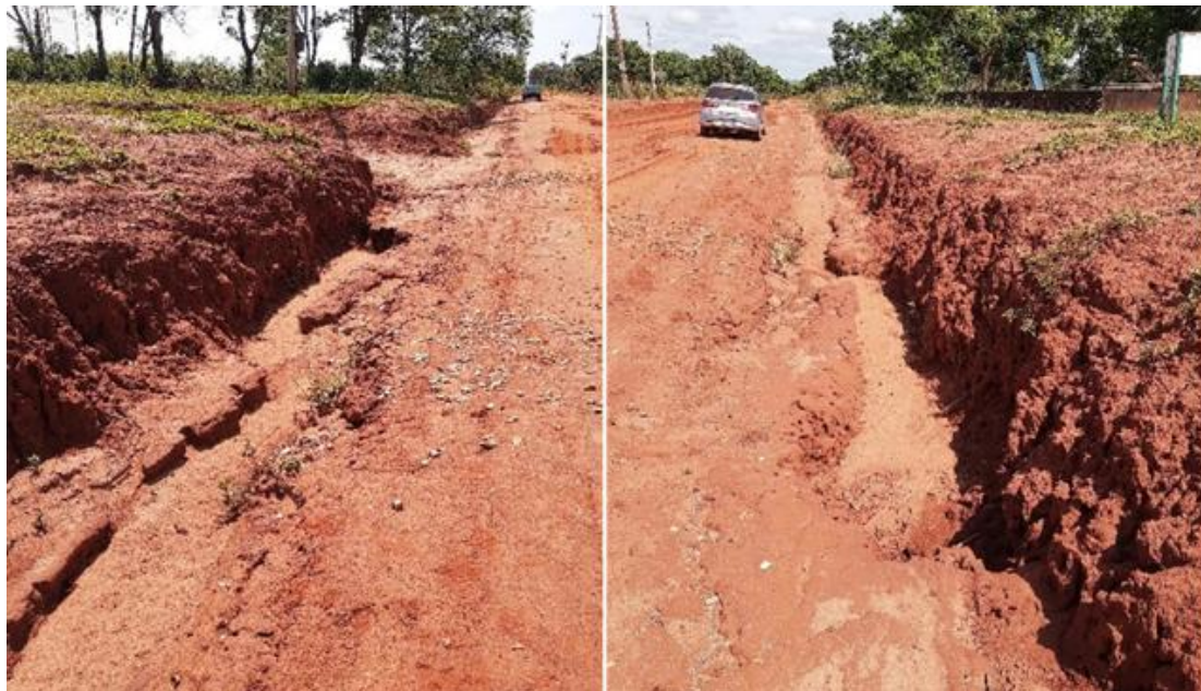
Figura 113: Ponto 01 - Processo erosivo à beira da estrada.
