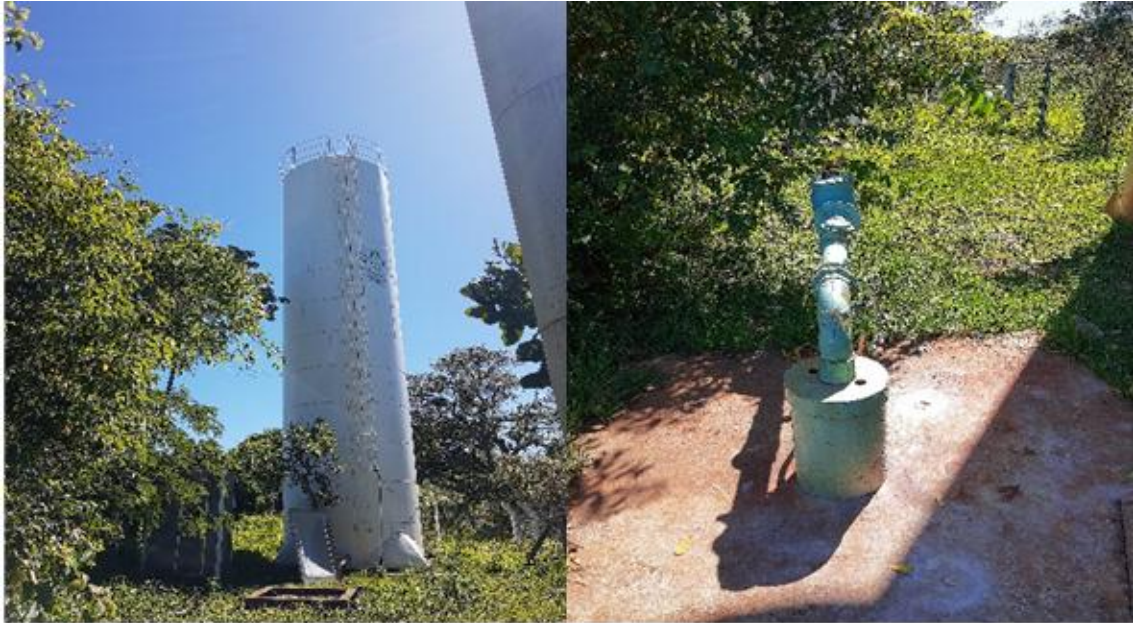
Figura 154: PT 02 e reservatório 02, na Aldeia indígena Amambai.
