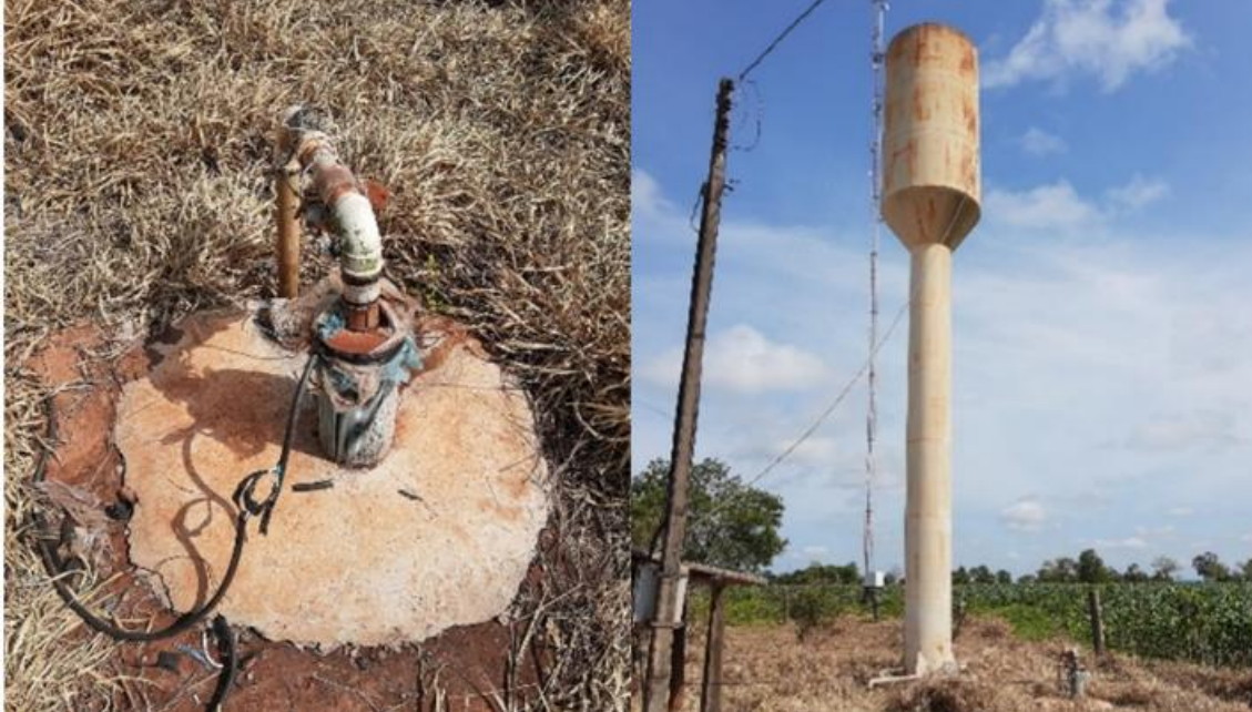
Figura 111: poço e reservatório 03 no Assentamento Rural Guanabara.
