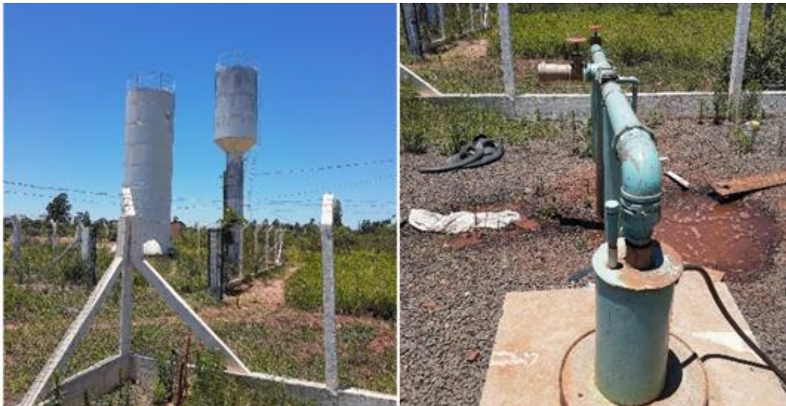
Figura 146: Reservatórios e poço artesiano PT 01
