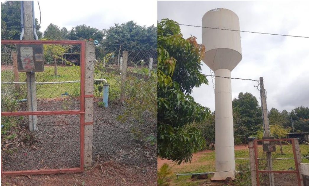
Figura 128: Poço e reservatório da associação de moradores 02, no assentamento Querência.
