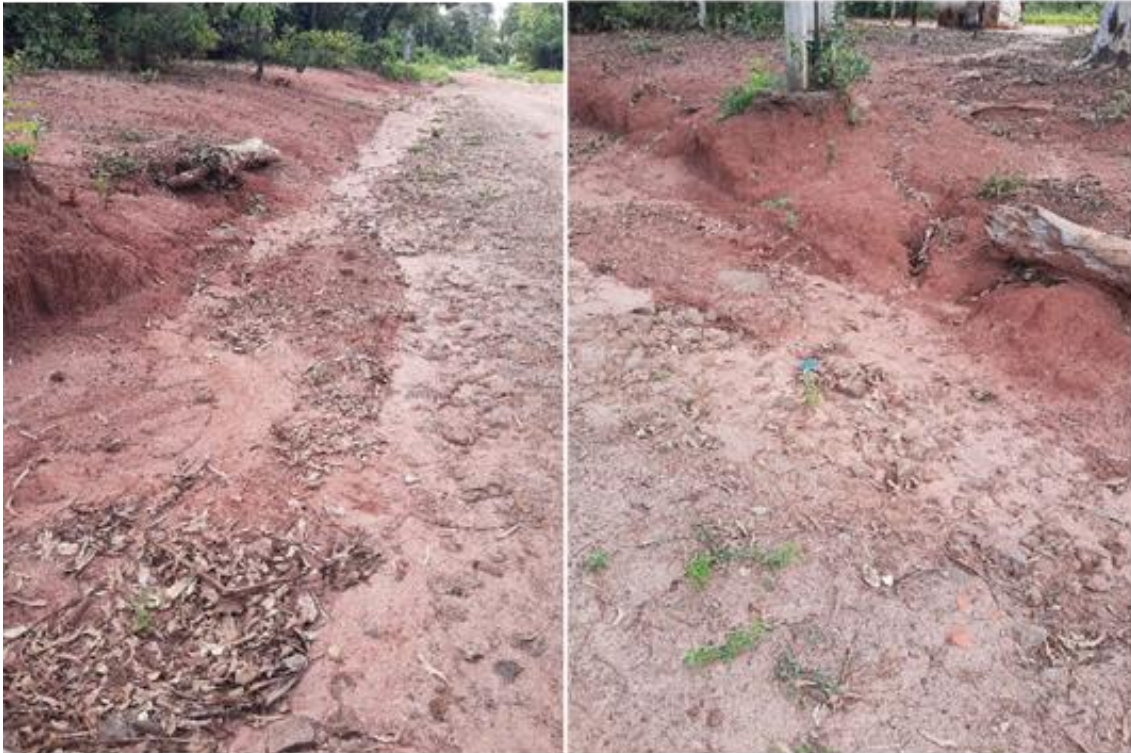
Figura 143: Ponto 01, onde é possível visualizar o caminho do fluxo de água e o carreamento de sedimentos, que iniciam um processo erosivo.
