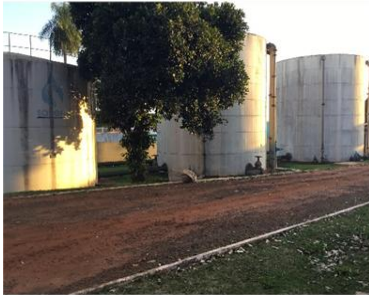
Figura 11: Reservatórios apoiados, próximo ao poço AMA 011 que se encontra desativado.
