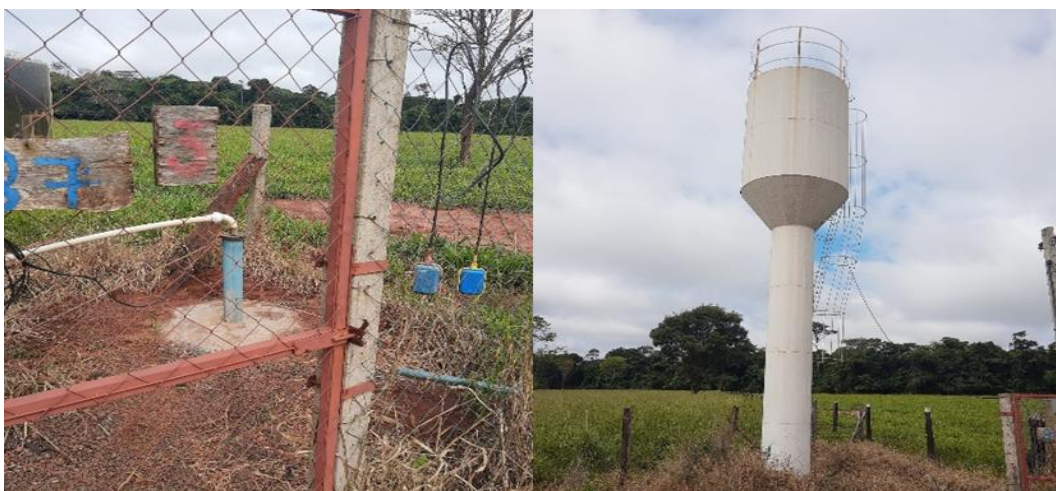
Figura 129: Poço e reservatório da associação de moradores 03, no assentamento Querência.
