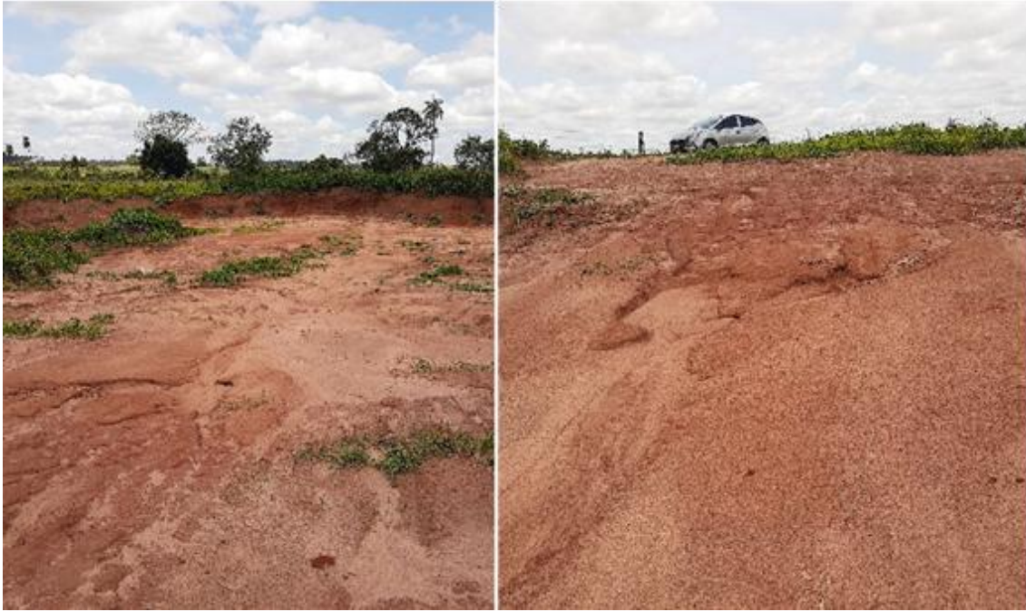
Figura 123: Formação de processos erosivos no ponto 01.
