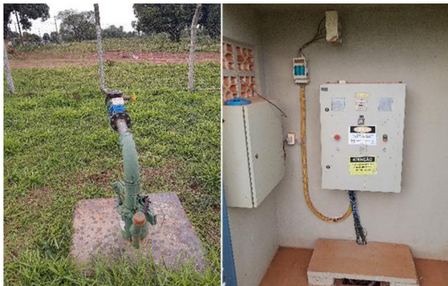
Figura 15: AMA 008 e estrutura de telecomando.
