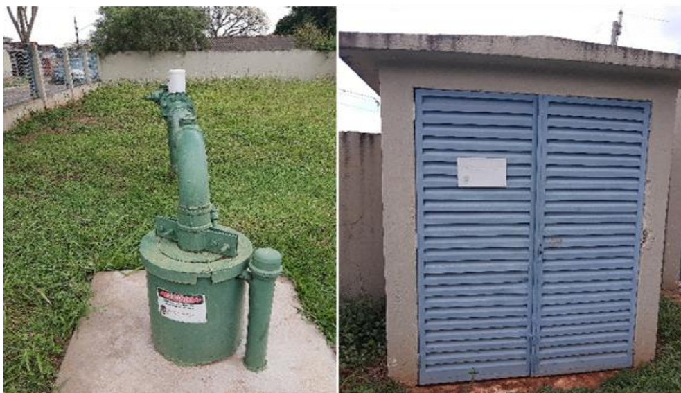
Figura 17: Poço AMA 012 e sistema de telecomando.
