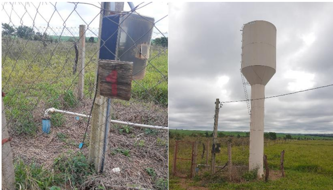
Figura 127: Poço e reservatório da associação de moradores 01, no assentamento Querência.
