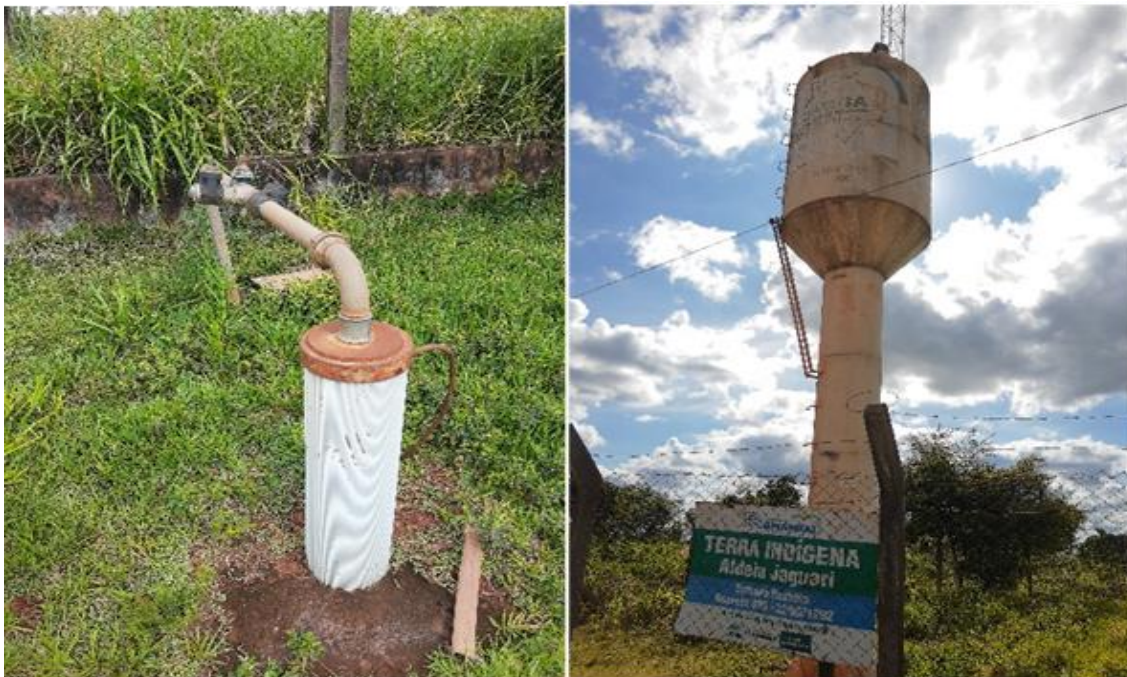
Figura 141: Poço artesiano e reservatório de abastecimento da Aldeia indígena Jaguari.
