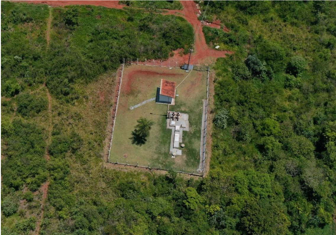
Figura 26: Estação Elevatória de Esgoto.
